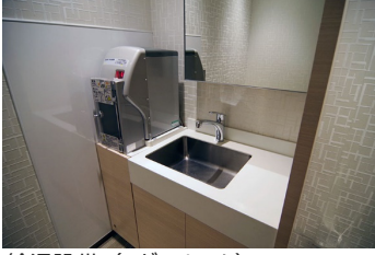
給湯設備（ベビールーム）
