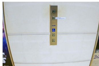
一般・車いす共用エレベーター
