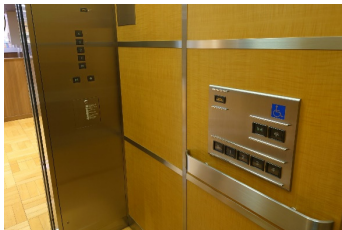
一般・車いす共用エレベーター
