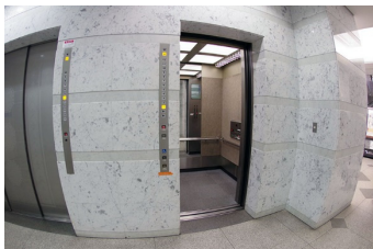
一般・車いす共用エレベーター
