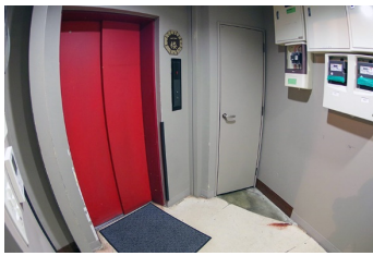
一般・車いす共用エレベーター
