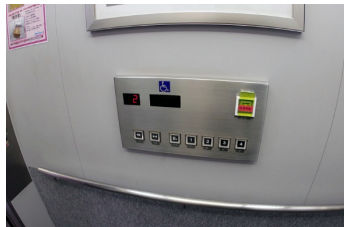
一般・車いす共用エレベーター (ボタン)
