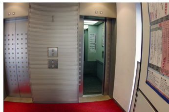
一般・車いす共用エレベーター
